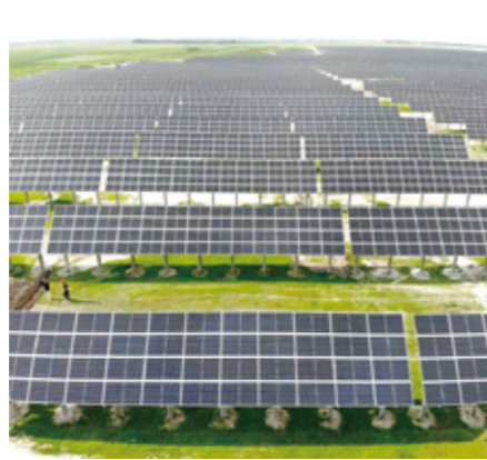
設置場所: 中国白城 設置容量: 100MW
