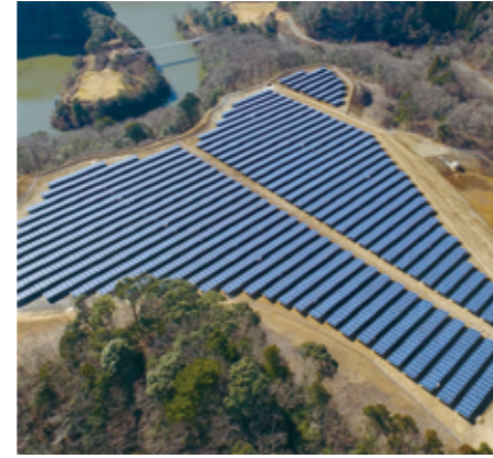
設置場所: 日本 千葉県君津市 設置容量: 2.3MW
